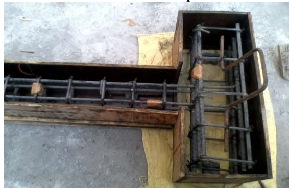
Fig:5 Column Setup Embedded With SA
